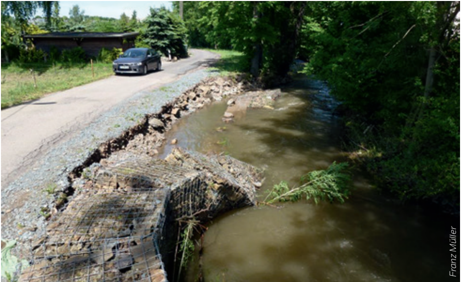
Gabionen wurden durch das Hochwasser zerstört.
